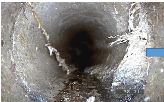
Abbildung 1: Kanalisationsleitung mit Wurzeleinwuchs
