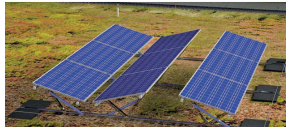
Modulanordnung Gründach PV-Anlage (Contec Greenlight on top)
